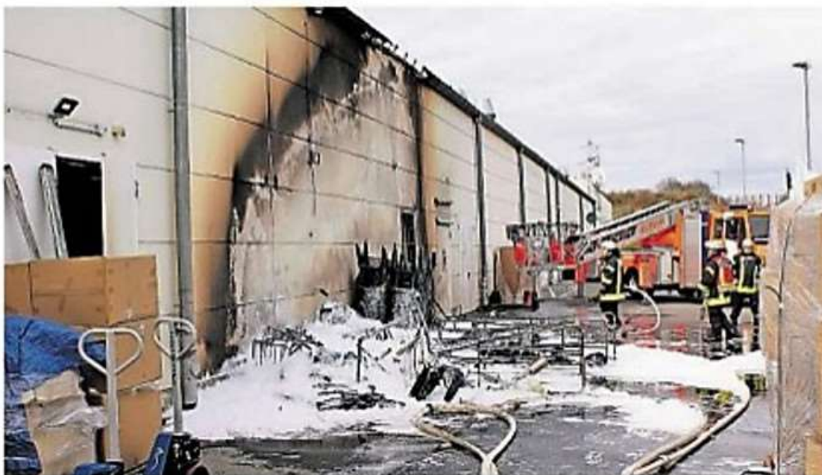
Ware im Außenbereich fing aus ungeklärter Ursache Feuer.
