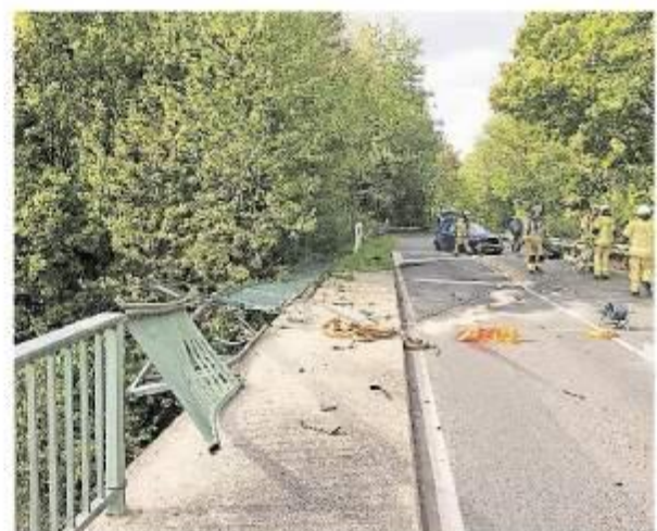
Zehn Meter des Geländers drohten abzustürzen.
