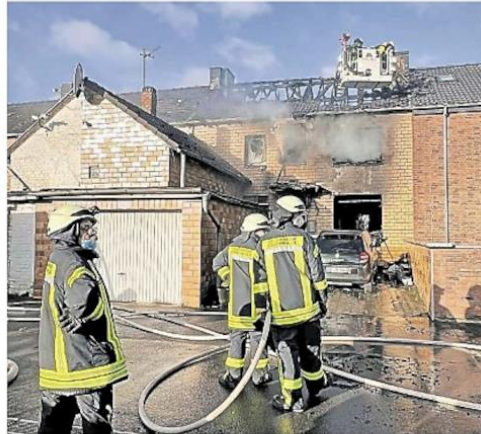
Bei einem Feuer in einem Wohnhaus an der Wilhelminenstraße in Eschweiler ist eine Frau lebensgefährlich verletzt worden.
